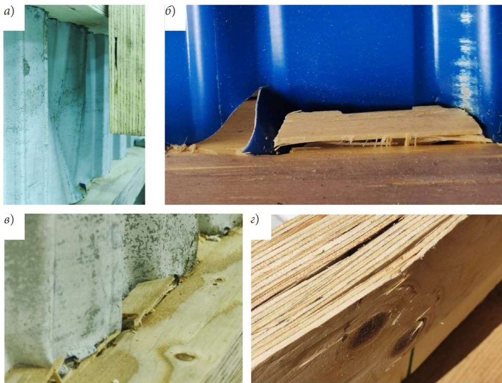
Рис. 5. Разрушение балки: а — потеря местной устойчивости стенки; б — разрыв стенки; в — выкалывание LVL между гофрами стенки; г — разрыв LVL нижнего пояса
