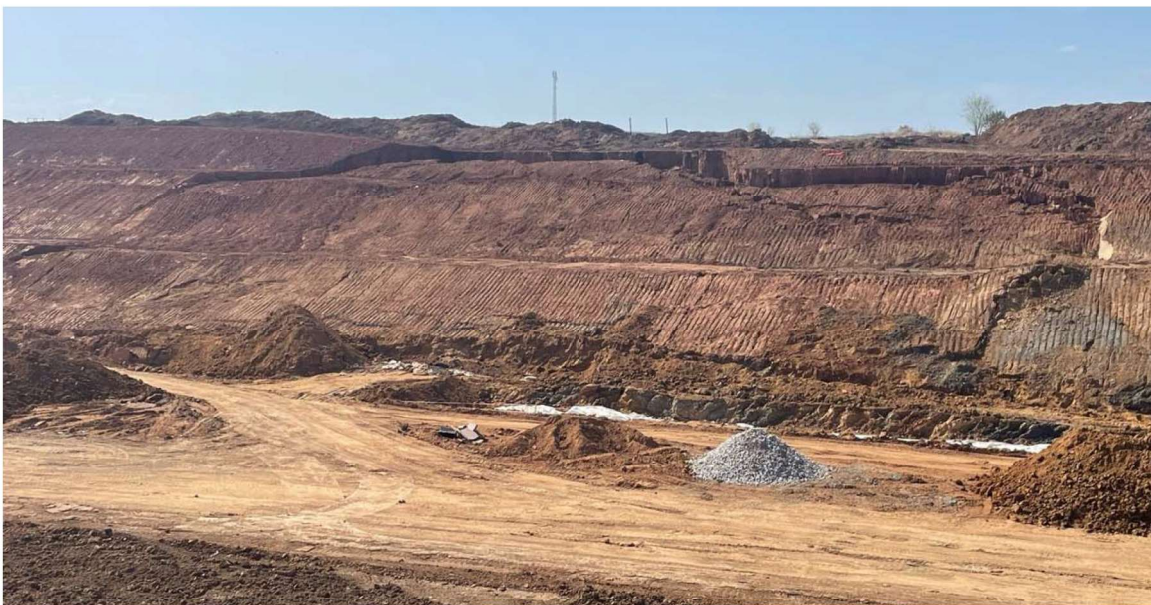
Рис. 1. Оползень на участке ПК224–ПК225 автомобильной дороги М-7 «Волга». Фото автора
